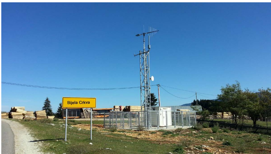
Objekat Daljinski upravljane kontrolno-mjerne stanice na lokaciji Bijela Crkva u opštini Rožaje
